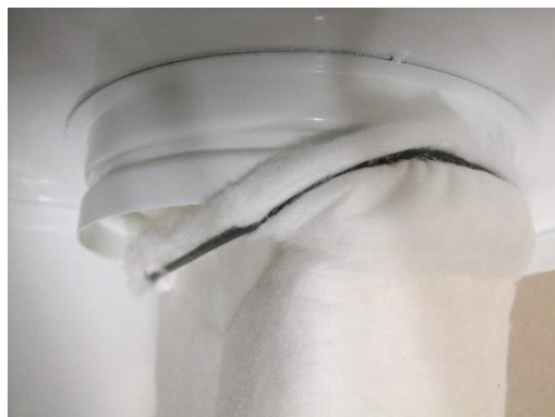
Fot 4. Widok częściowo zsuniętej opaski oraz filtra na króćcu.
