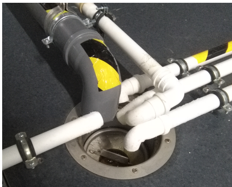
Zdj. nr 22 Przykład kratki pośredniej odbierającej kondensat z centrali
