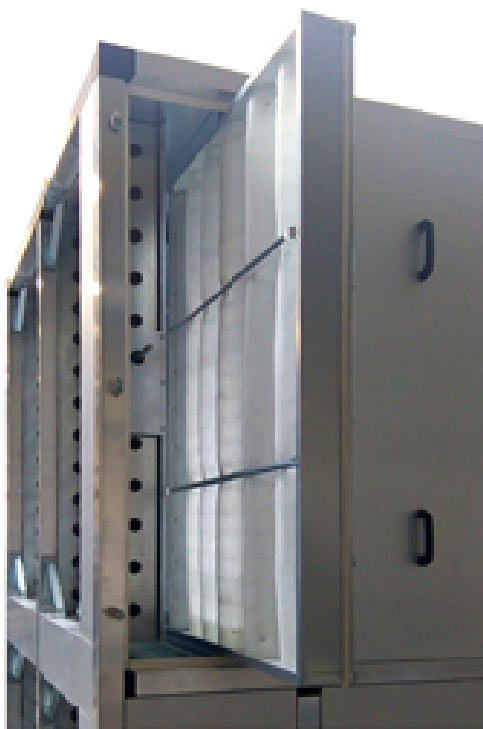
Zdj. nr 25 Sekcja filtrów kasetowych – wysuwanie.
